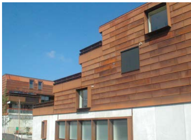
Farum Midtpunkt – 45 år og intet tegn på forfald. Mange byggerier opføres i dag med facader af Corten-stål. Det mest kendte byggeri af slagsen herhjemme er Farum Midtpunkt, der efter 45 år stadig ikke viser tegn på forfald. Eiffeltårnet står stærkt siden 1889.
